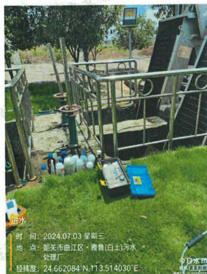
污水厂进水口
