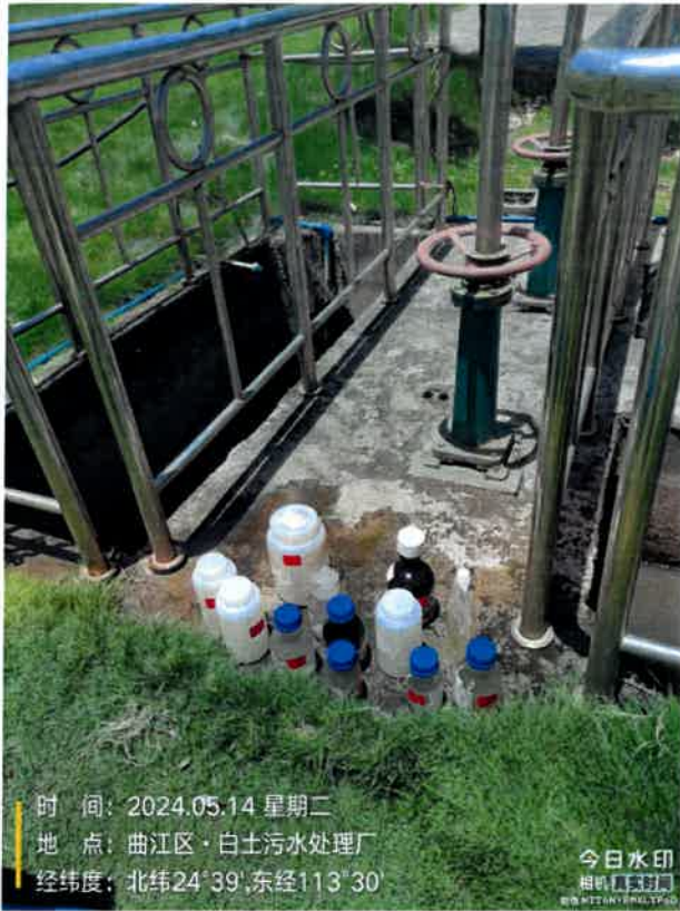
污水厂进水口
